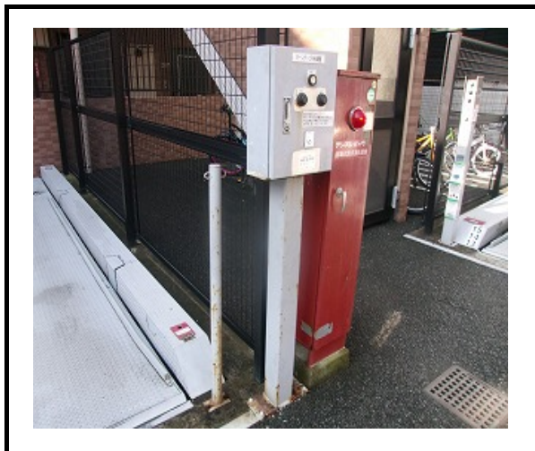
②ターンテーブル操作盤作業前
